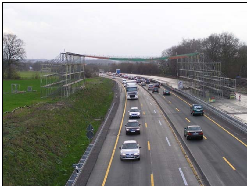
Abb. 10: Stahlrohrschutzkonstruktion mit Netz über einer Autobahn
