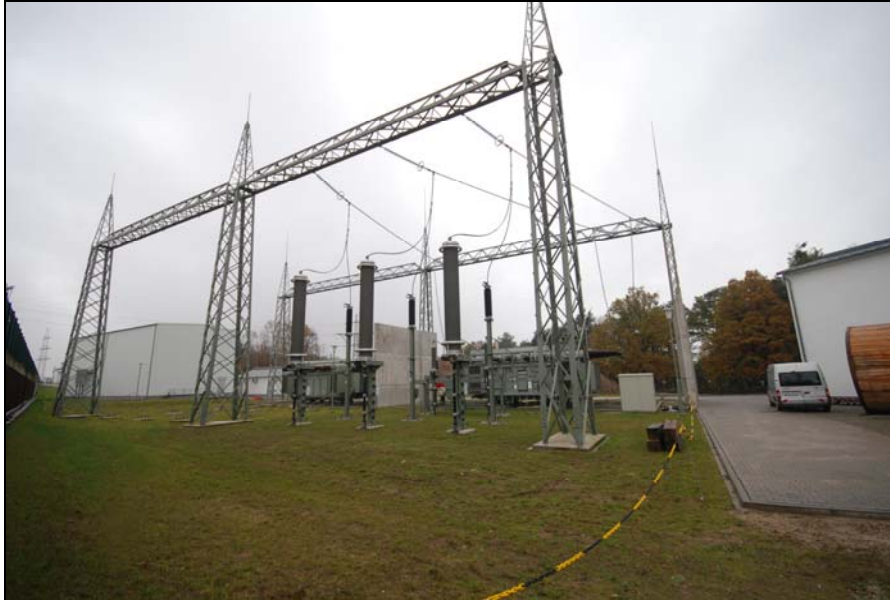
Abb. 18: Kabelendverschlüsse und Portal
